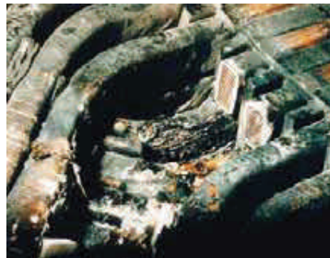
Fallo en el bobinado de estátor de un Motor
