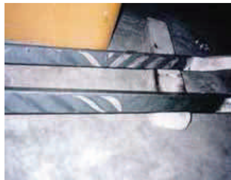
Fallo en barras estatóricas de un Turbogenerador
